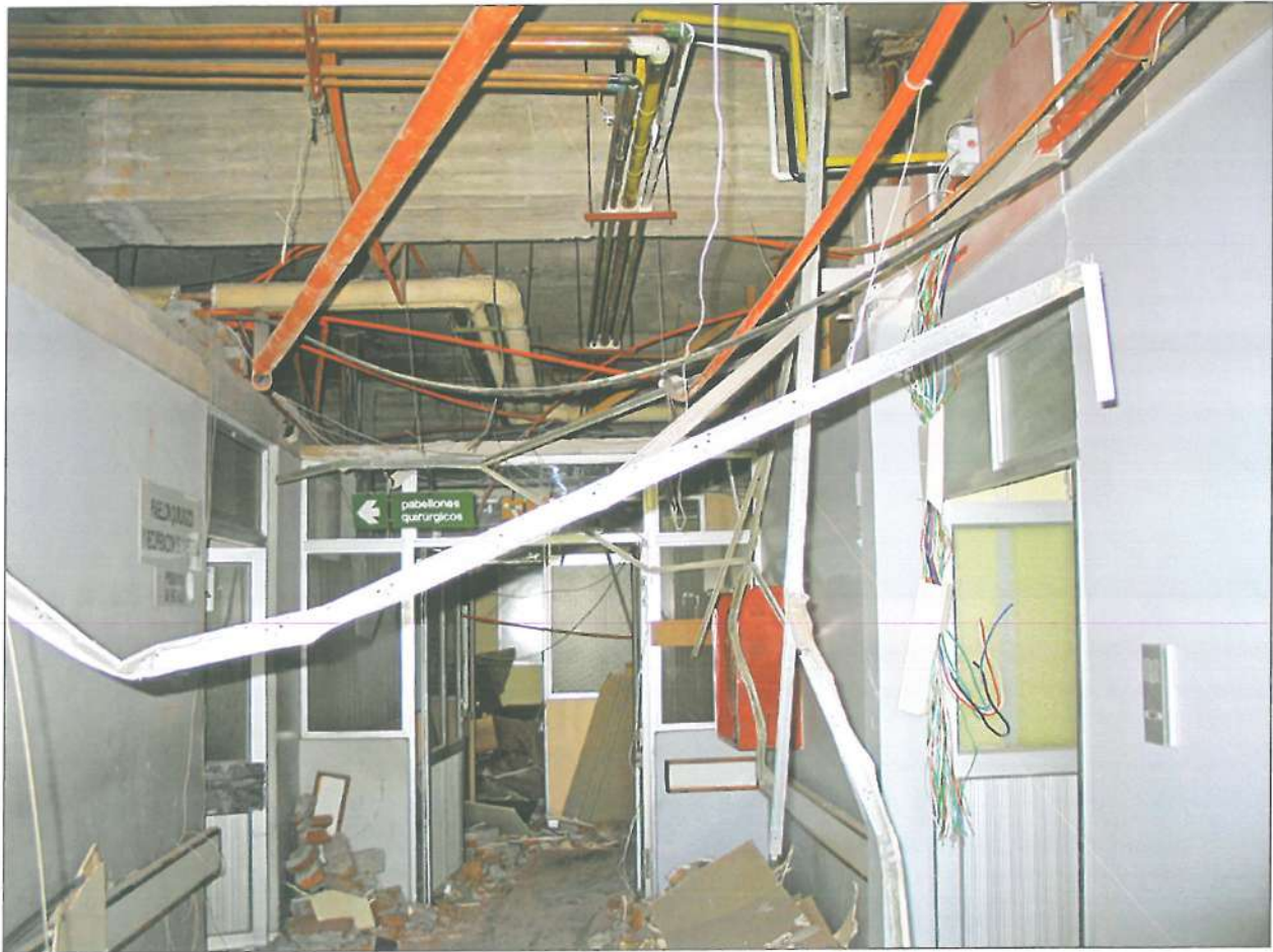
شکل ۱: عوارضی‌های غیرسازه‌ای در بیمارستان Talca زلزله ۲۰۱۰ (شیلی)
