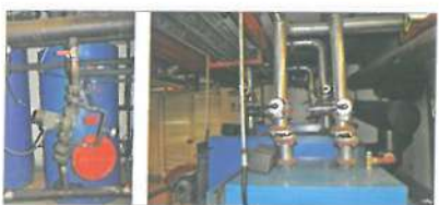
شکل ۲- الف) و ب) گونی جامبی در اثر انتقال جامبی (ب) عملکرد مناسب سیستم تاسیسات در ساختمان بیمارستان زلزله ۲۰۱۰ شیلی
