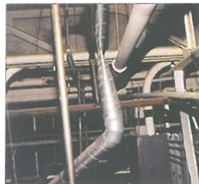
شکل ۴: آسیب دیدگی لوله در اثر برخورد
