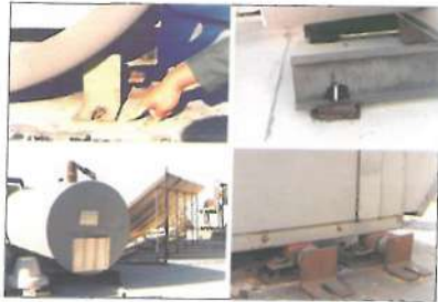
شکل ۶- آسیب‌های وارده به اجزای غیرسازه‌ای نصب شده در بام ساختمان ۱۰ طبقه Burebank زلزله‌نورث ریح کالیفرنیا
